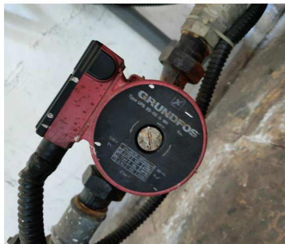
Figura 5: Gruppo di pompaggio
