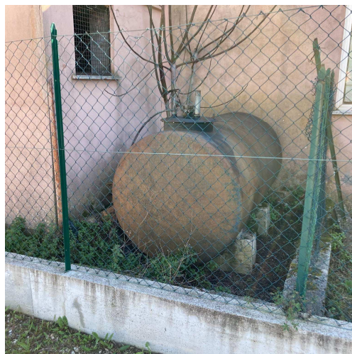
Figura 3: Serbatoio di gasolio esterno
