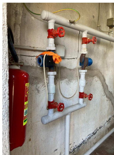
Figura 5: Gruppo di pompaggio
