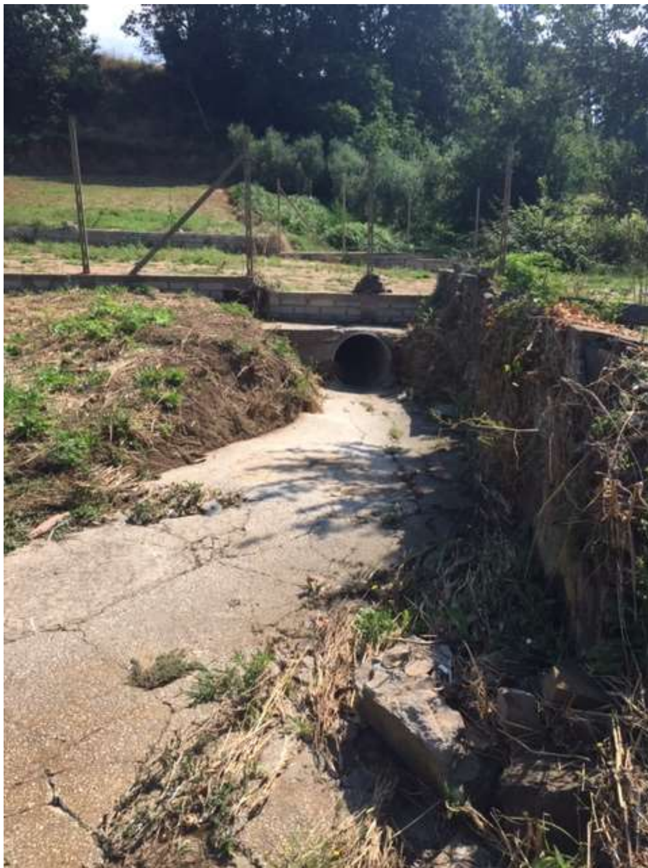
Figura 11 - Canale cementato al limite della Proprietà Guglielmi
