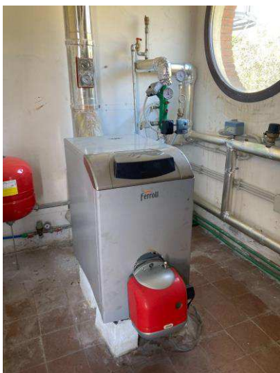
Figura 2: Caldaia attualmente installata
