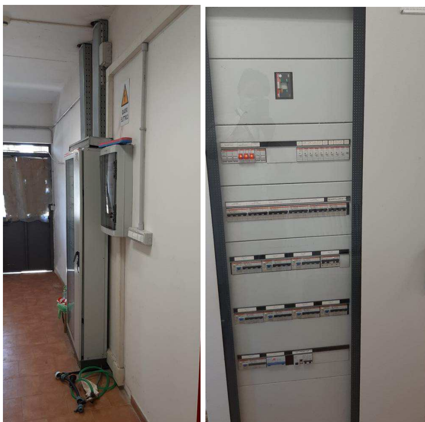
Figura 3: Quadro Elettrico Generale
